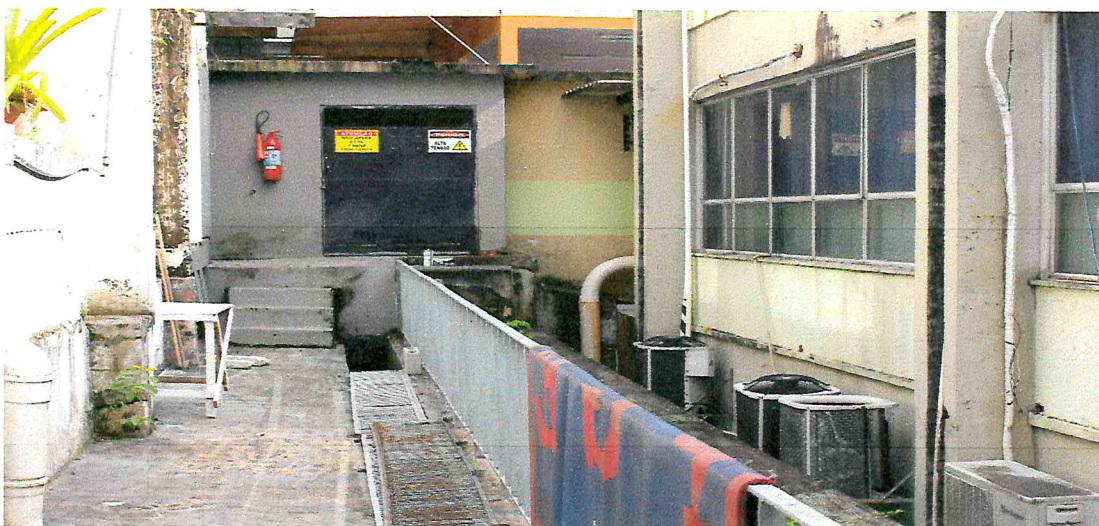
Imagem 2: Limite Leste (Fundo) onde esta locada a Subestação e Quadro Geral de Baixa tensão. (Fonte da Imagem: Equipe técnica da PPIF/PGE)
