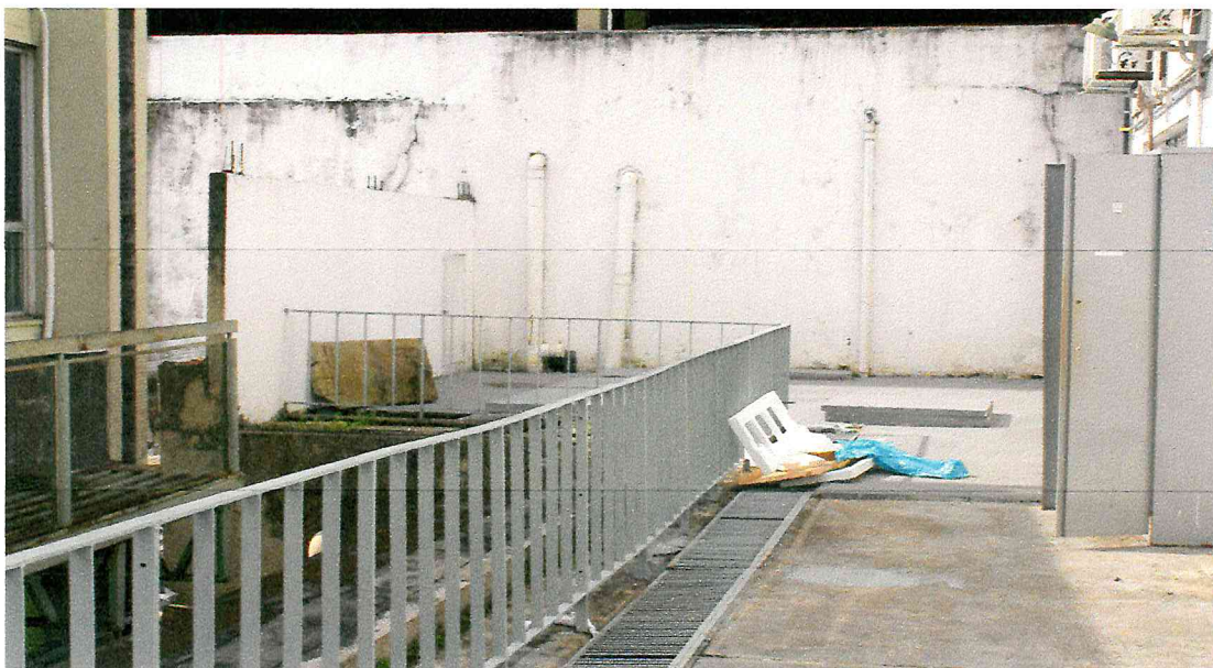
Imagem 3: Limite de fundo do prédio da PGE com a Prodam (lado Sul) (Fonte da Imagem: Equipe técnica da PPIF/PGE)
