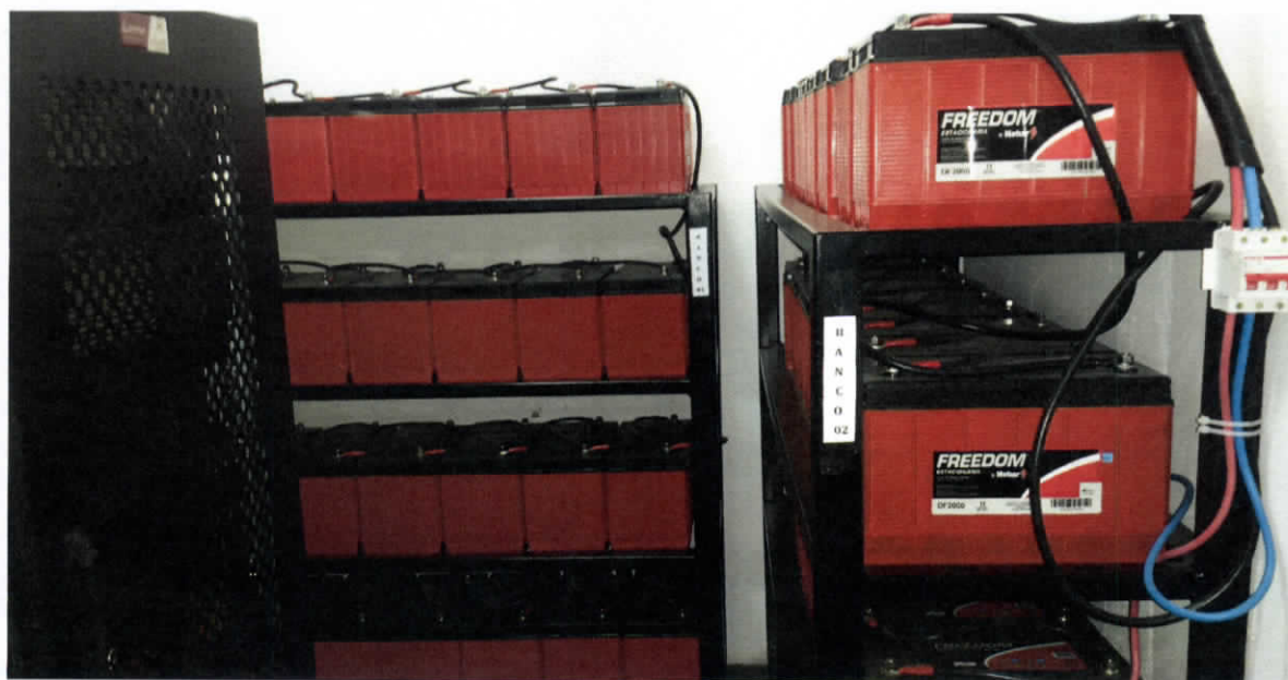
FOTO 04 – BANCO DE BATERIAS NO DATA CENTER DA EYES N'WHERE
