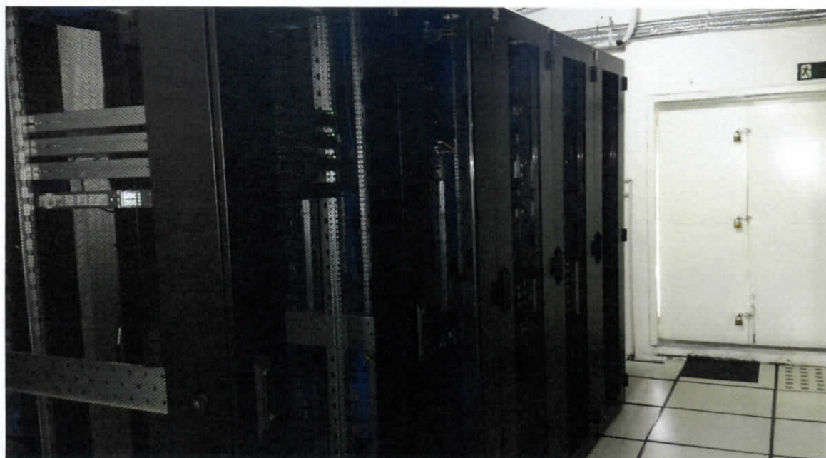
FOTO 03 - DATA CENTER DA EYES N'WHERE
