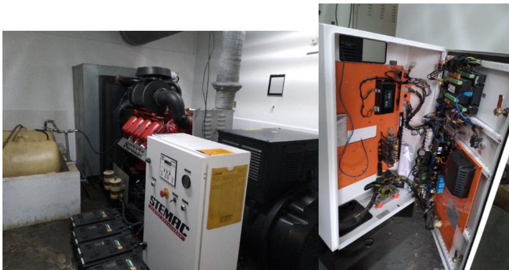
Figura 1. Unidade de Supervisionamento de Corrente Alternada (USCA).
