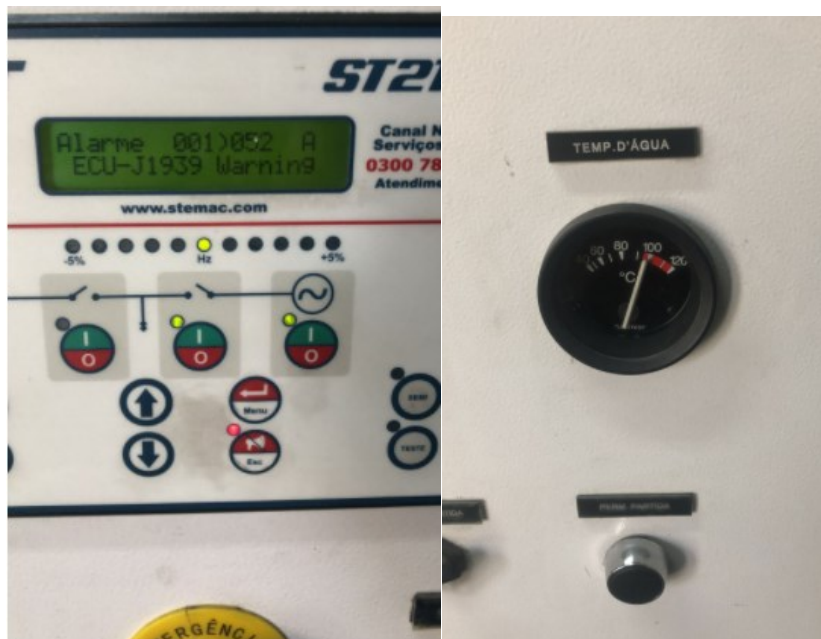
Figura 1. Código de alarme 052 e temperatura próximo a 100°C.
